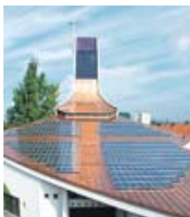
Fotovoltaikanlage der Kirche St. Konrad in Linz.
